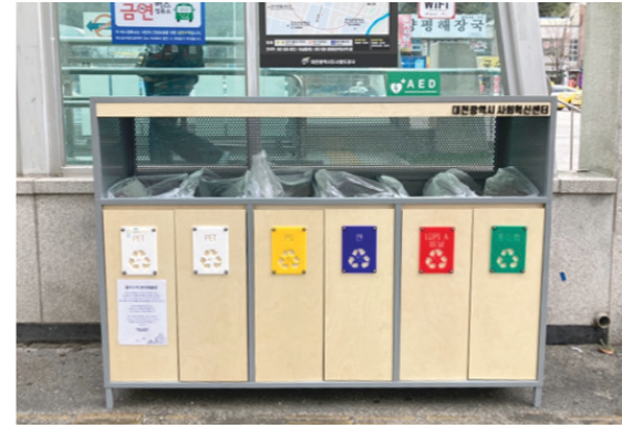
분리배출함 설치 현장(2021)
